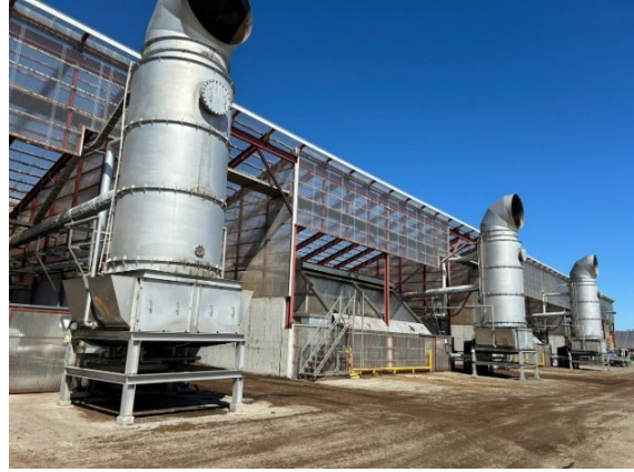
強制発酵設備
